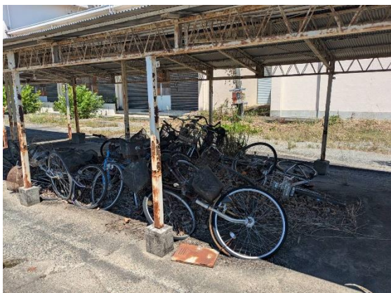
被災後の駐輪場
