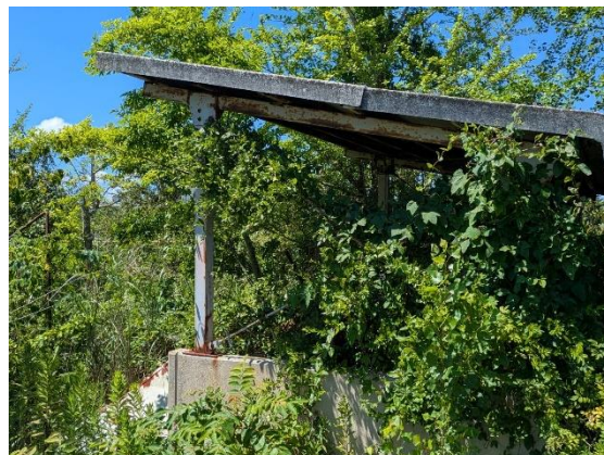
被災してから 使用していない ブルペン
