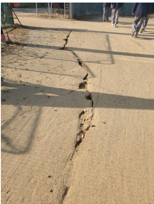
ひび割れたグラウンド
